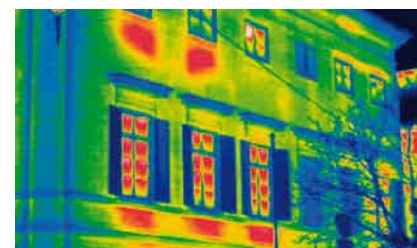
Niedocieplone wnęki grzejnikowe, niewypełnione szczeliny między cegłami
